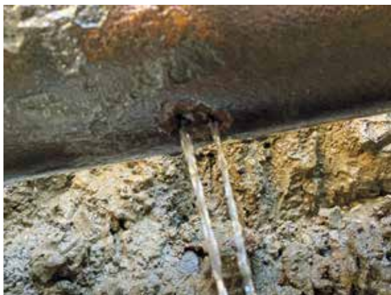
Lochfrass-Leck an der Turenmattenstrasse
