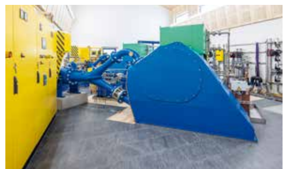
Zentrale MII – Inbetriebnahme Dezember 21
