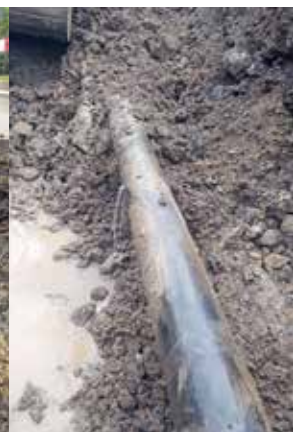
Längsriss Unterbach Hauptleitung GG150
