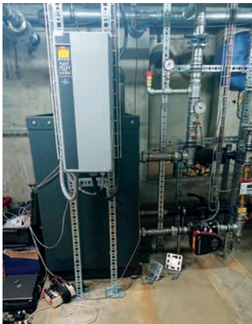
Inbetriebnahme Wärmepumpe Alpbächli
