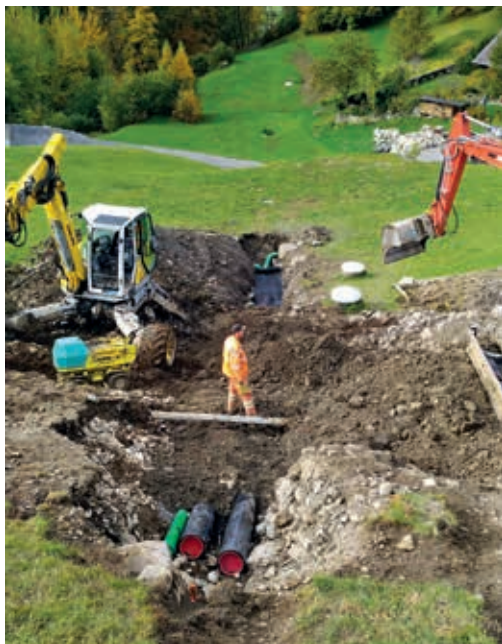
Neue Ableitungen der Quelle 15003
